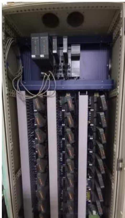
Рисунок 2 - Общий вид модулей СРУ в электротехническом шкафу
