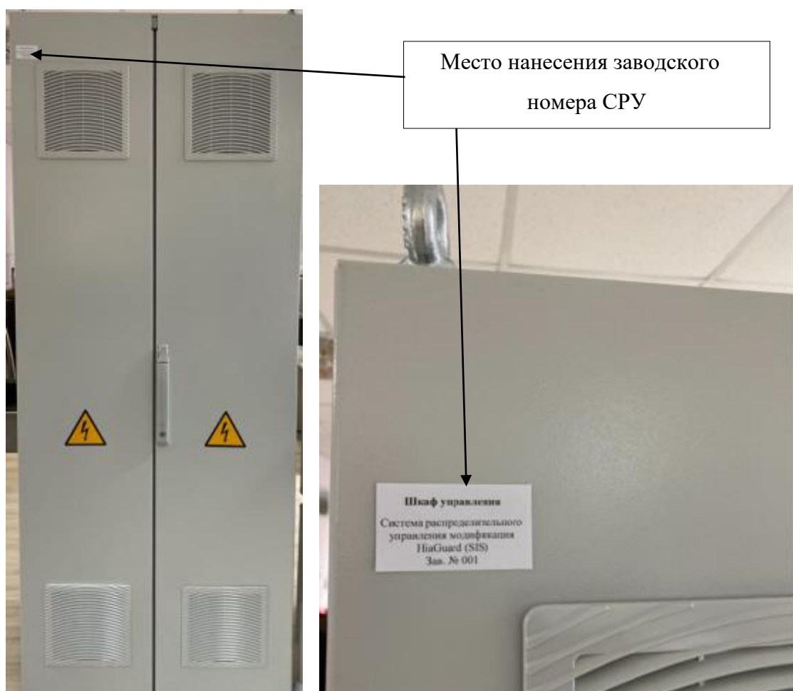
Рисунок 1 – Общий вид электротехнического шкафа СРУ с указанием места нанесения заводского номера
