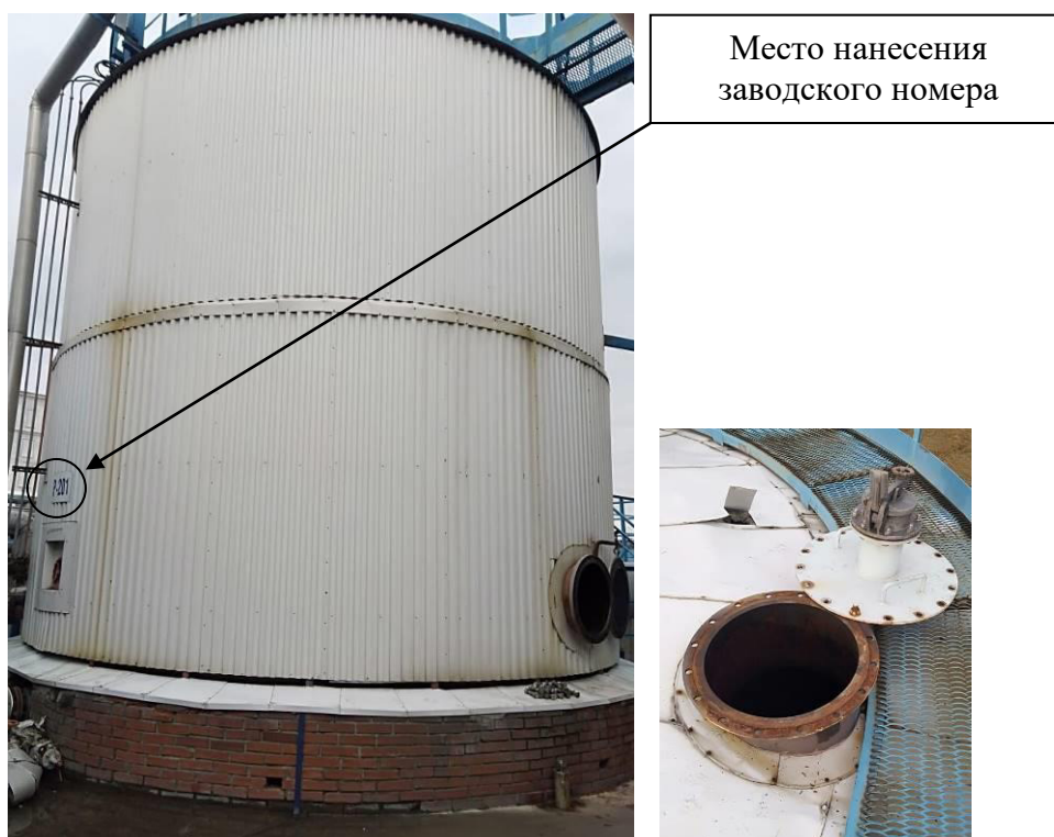
Р и с у н о к 2 – Общий вид резервуара с заводским номером P-201 и его замерного люка
