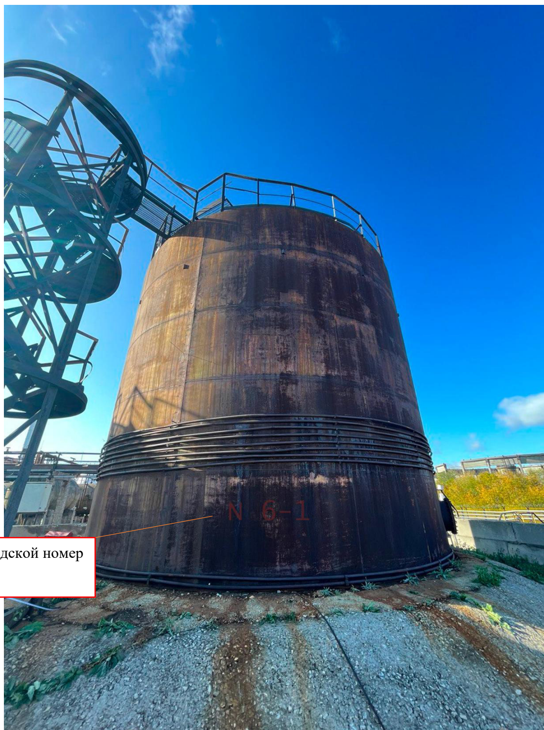
Рисунок 1 - Общий вид резервуара вертикального стального цилиндрического РВС-400 заводской номер 6-1 с указанием места нанесения заводского номера
