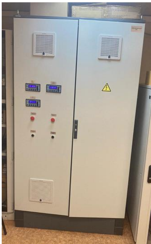
Рисунок 1 – Шкаф с оборудованием Комплекса
