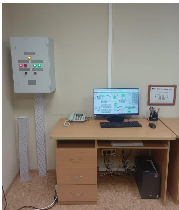
Рисунок 3 – Основная рабочая станция оператора
