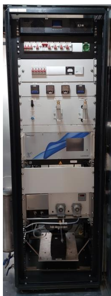
Рисунок 1 – Общий вид шкафа с газоанализатором марки ProCeas
