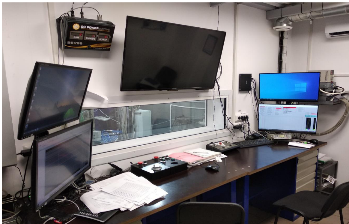
Рисунок 4 – Помещение пультовой, место оператора
