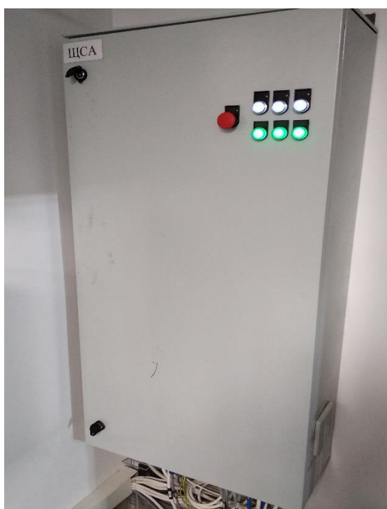
Рисунок 2 – Электрошкаф питания измерительной системы и стенда. Общий вид
