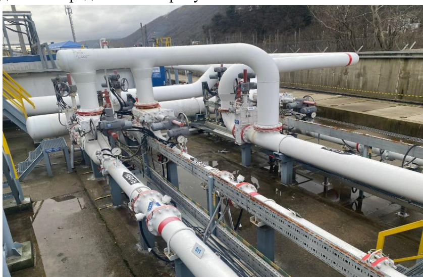
Рисунок 1 - Общий вид СИКН
