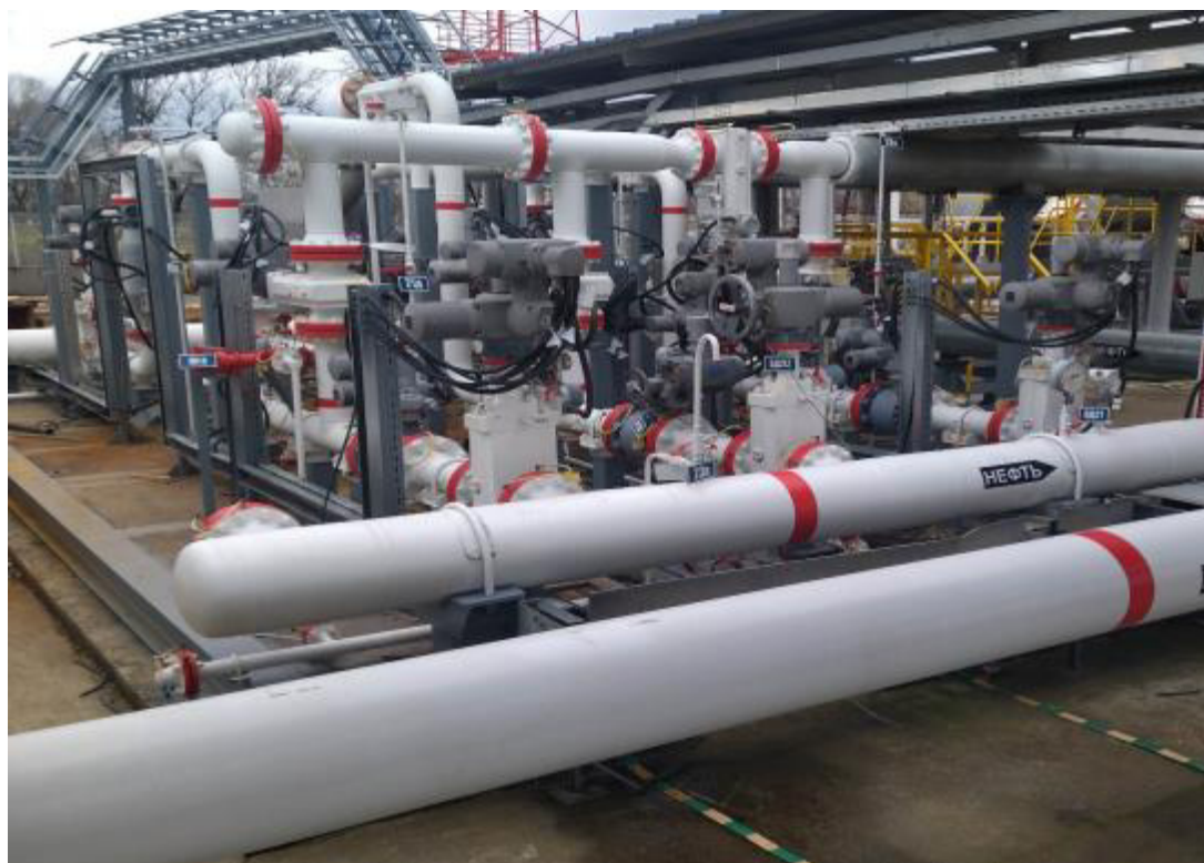
Рисунок 1 – Общий вид СИКН
