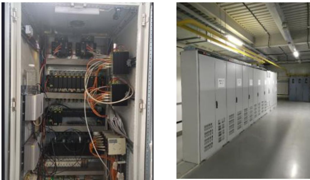
Рисунок 1 – Внешний вид контроллерных шкафов
