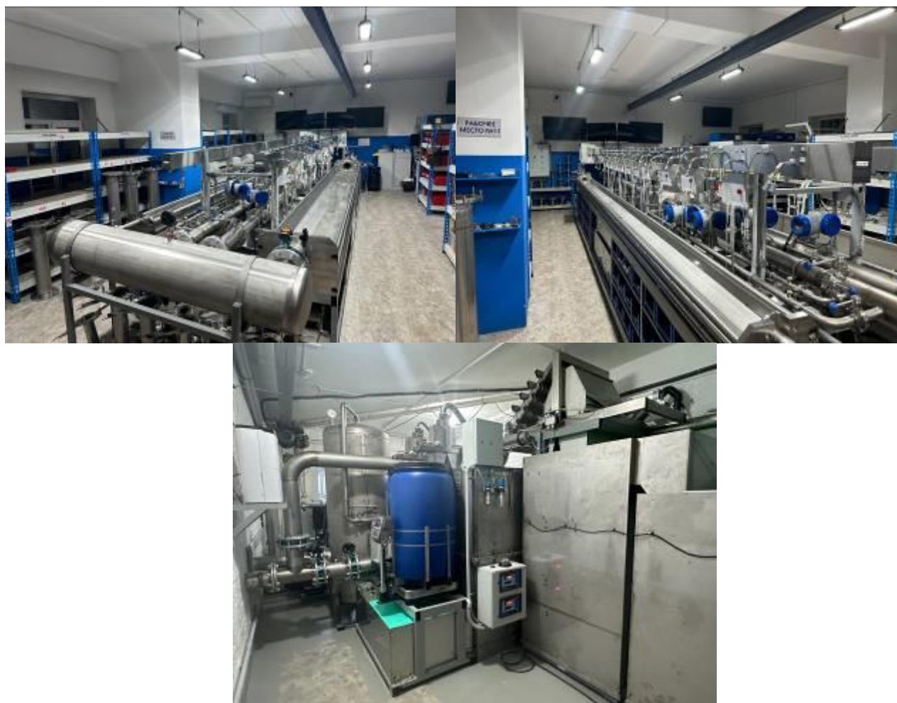
Рисунок 1 – Общий вид установки
