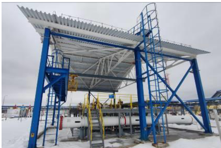
Рисунок 1 - Общий вид СИКН
