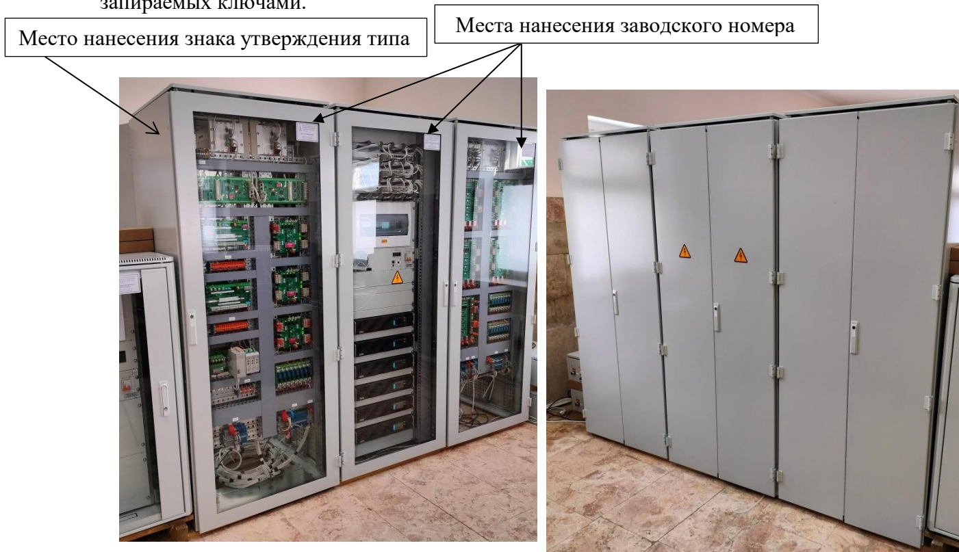
Рисунок 1 – Общий вид АСУ-С2 спереди: шкаф управления РМ1 (слева), шкаф сетевых коммутаторов и ИБП (в центре) и шкаф управления РМ2 (справа).
