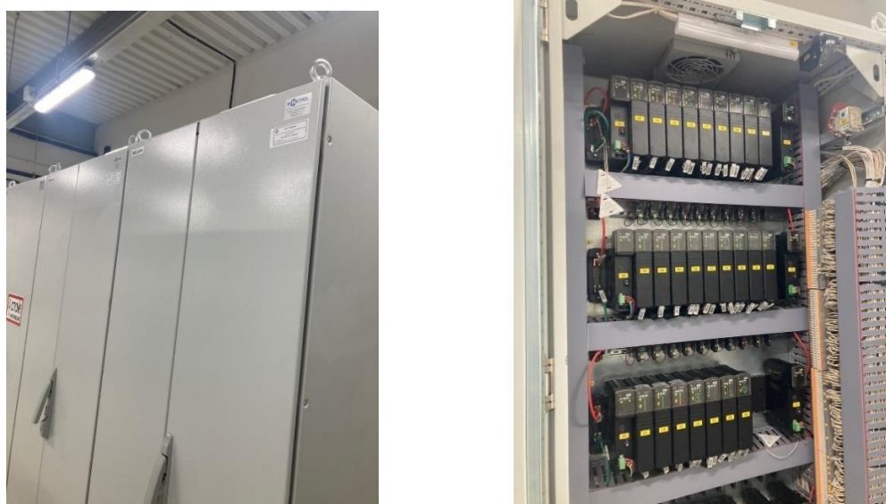
Рисунок 2 – Внешний вид контроллерных шкафов
