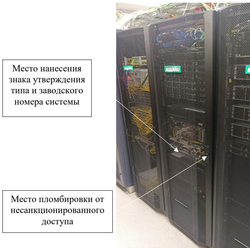
Рисунок 1 – Общий вид серверного шкафа, места пломбировки от несанкционированного доступа и места нанесения знака утверждения типа и заводского номера системы
