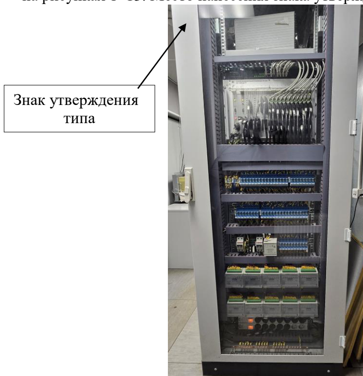
Рисунок 1 - Шкаф измерительного оборудования
