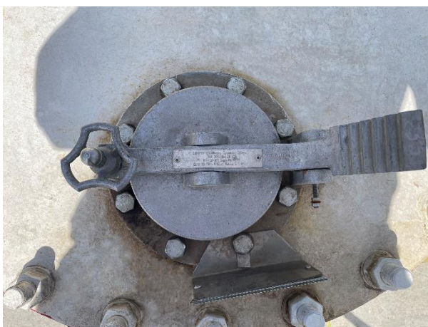
Рисунок 3 – Замерной люк резервуара РГС-20
