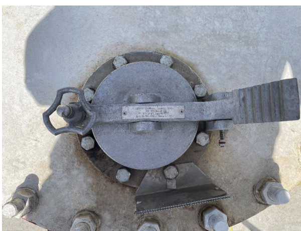
Рисунок 3 – Замерной люк резервуара РГС-20
