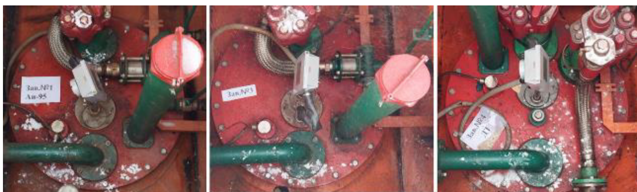
Рисунок 2 – Горловины резервуаров РГС-50 зав.№№ 1, 3, 4
