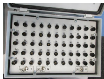
Рисунок 11 – Блок коммутации испытательных сигналов. Вид общий (дверь открыта)
