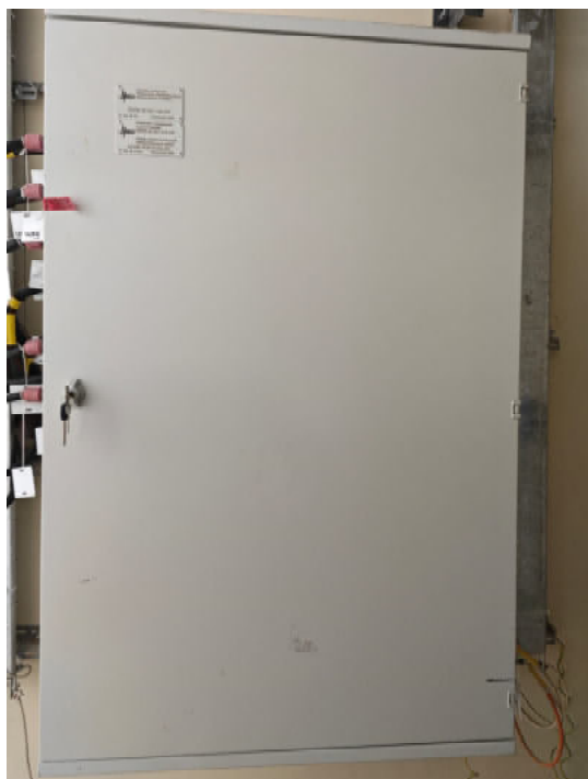
Рисунок 6 – Шкаф коммутационный измерительный ШКИ. Вид общий (дверь закрыта)
