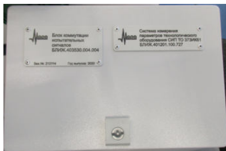
Рисунок 10 – Блок коммутации испытательных сигналов. Вид общий (дверь закрыта)
