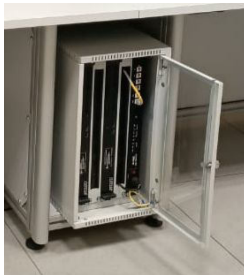
Рисунок 9 – Рабочая станция оператора. Вид общий
