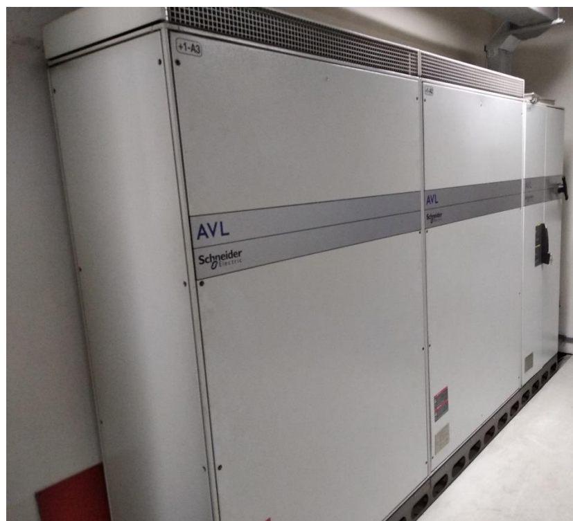
Рисунок 2 – Электрощкаф асинхронной машины DYNOFORCE ASM 5000/1/7-4. Общий вид
