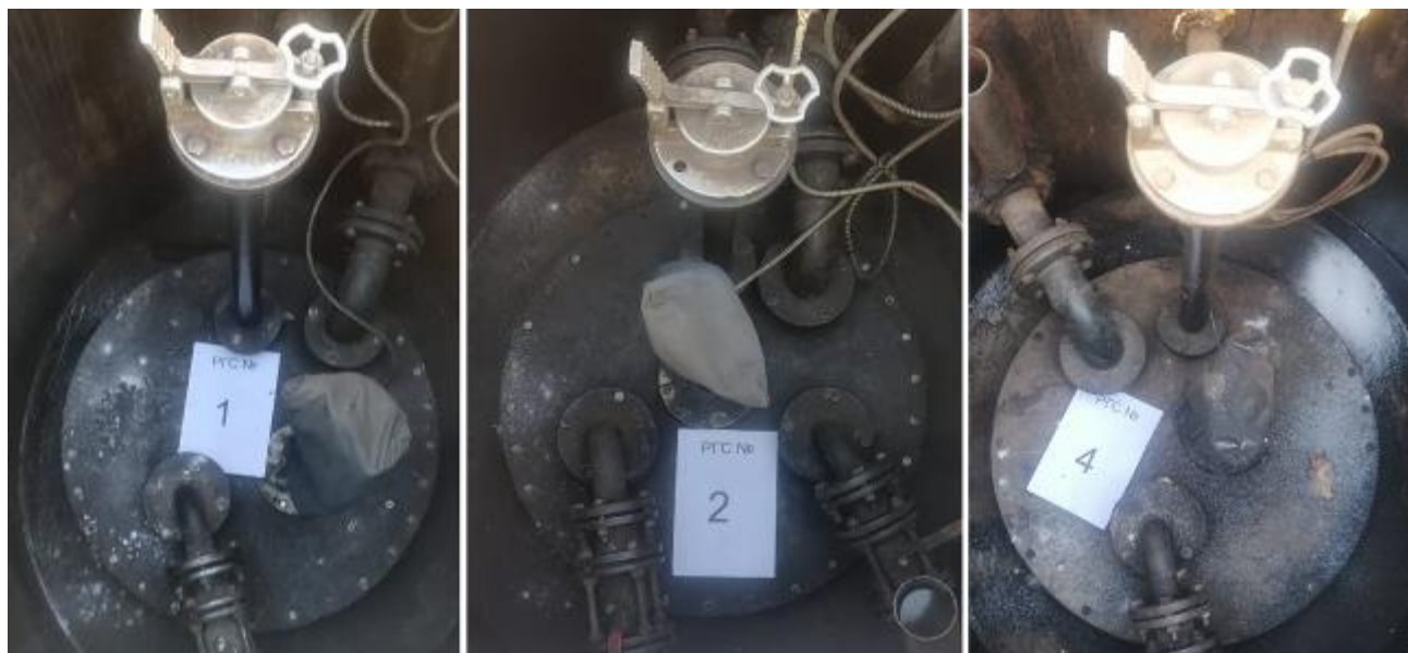
Рисунок 2 – Горловины резервуаров РГС-53 зав.№№ 1, 2, 4
