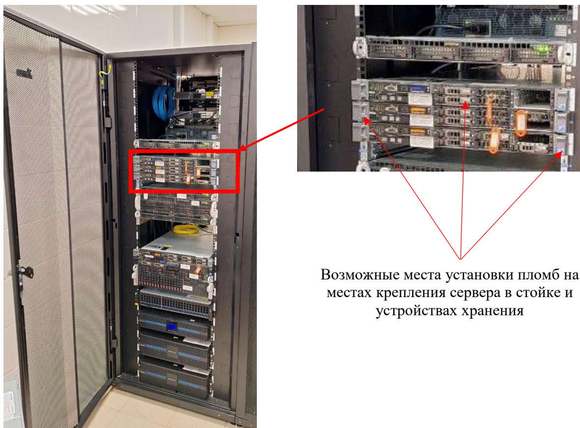
Рисунок 2 – Внешний вид стива с открытой дверью и установленным оборудованием
