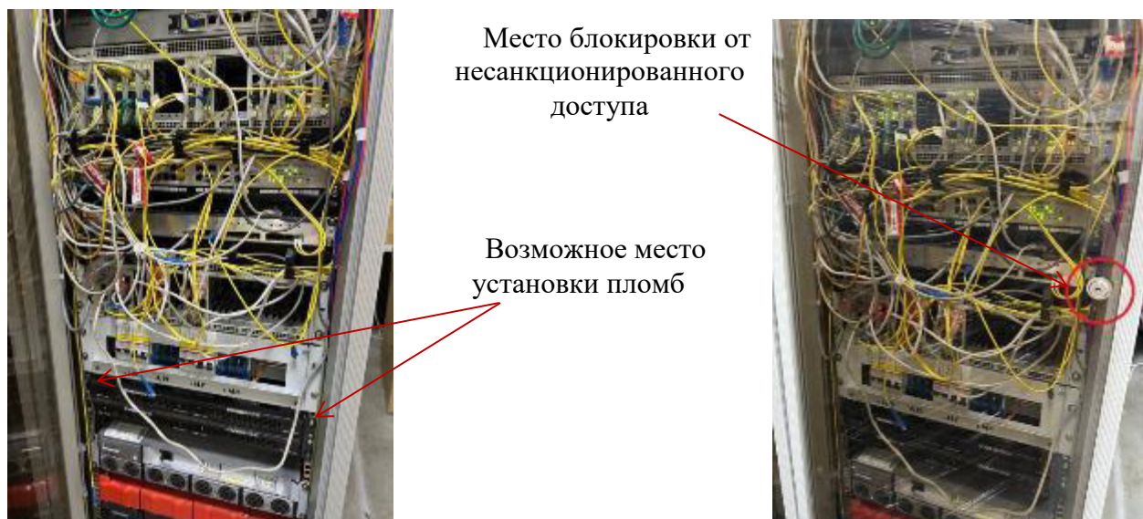
Рисунок 1 – Внешний вид стойки с установленным оборудованием
