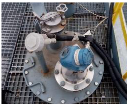
Рисунок 3 – Замерной люк резервуара РГС-20
