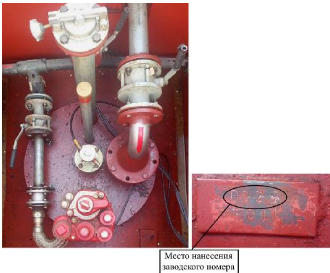
Рисунок 3 – Горловина и измерительный люк резервуара РГП 25-1-2(0,85)-О-У зав.№ 0229
