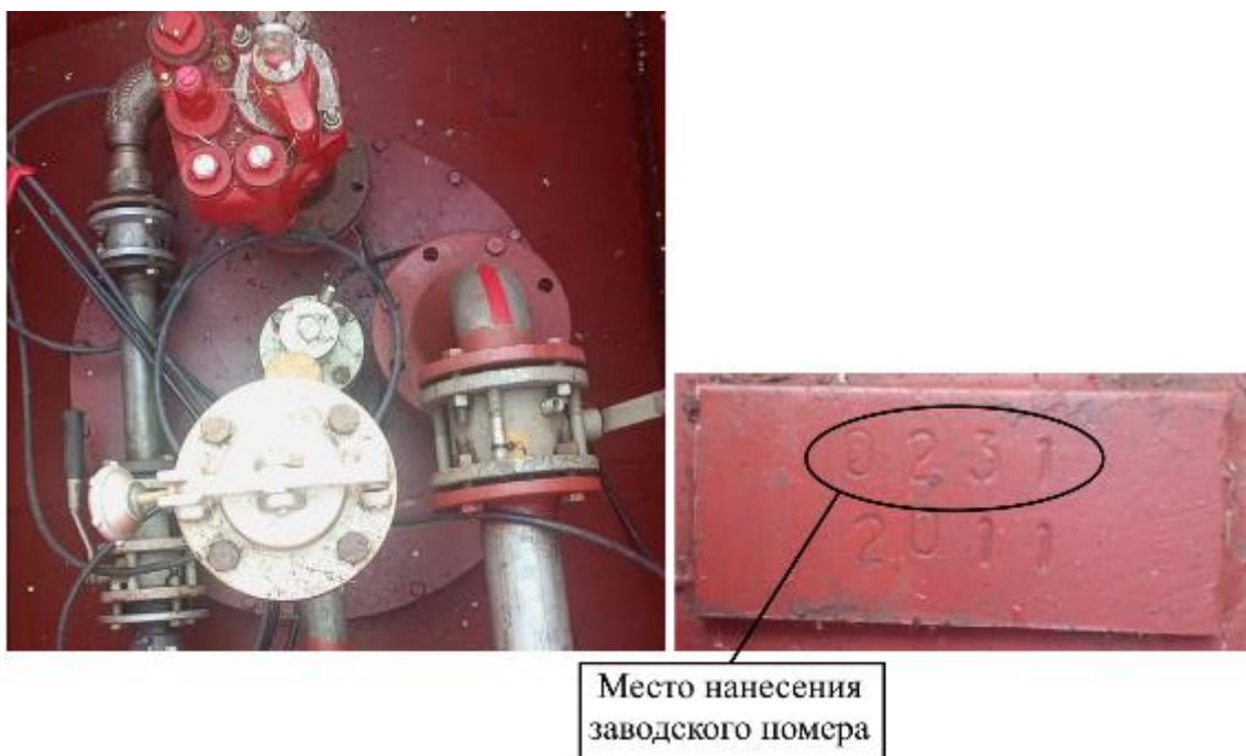
Рисунок 5 – Горловина и измерительный люк резервуара РГП 25-1-2(0,85)-О-У зав.№ 0231
