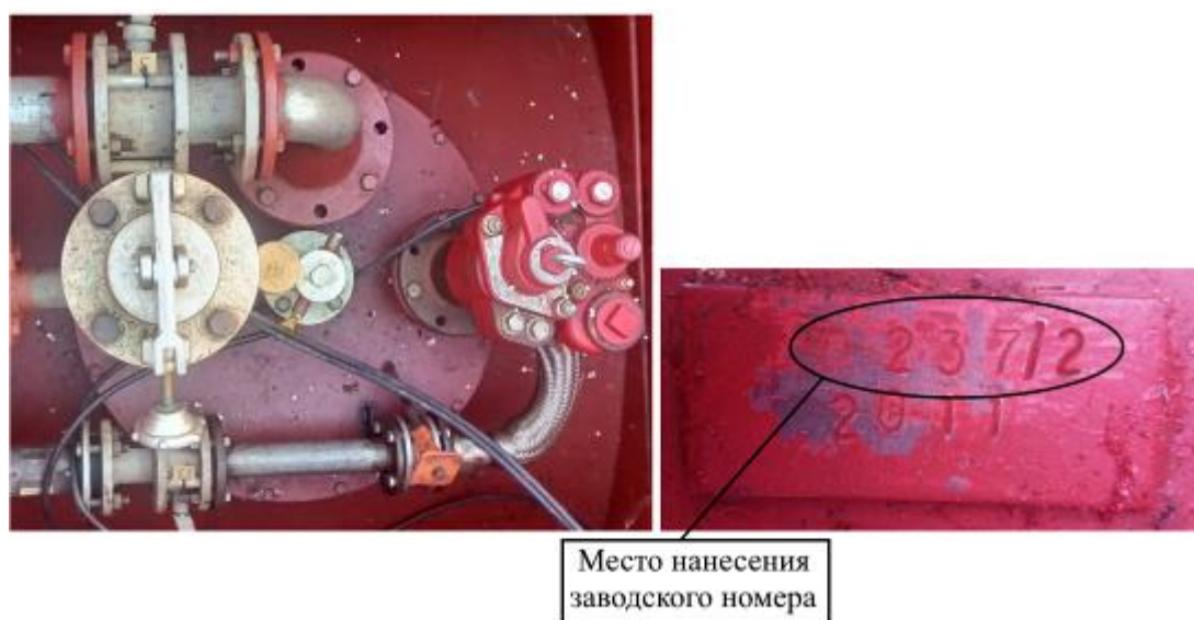
Рисунок 8 – Горловина и измерительный люк резервуара РГП 25-1-2(0,85)-О-У зав.№ 0237/2
