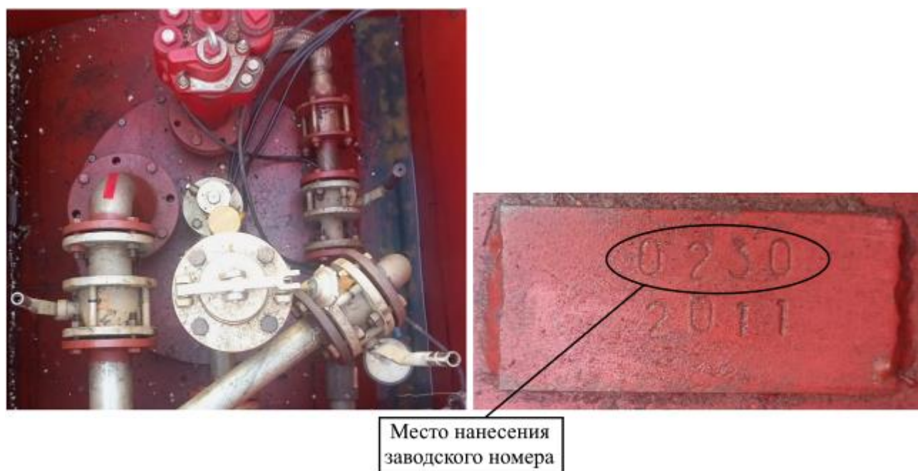
Рисунок 4 – Горловина и измерительный люк резервуара РГП 25-1-2(0,85)-О-У зав.№ 0230
