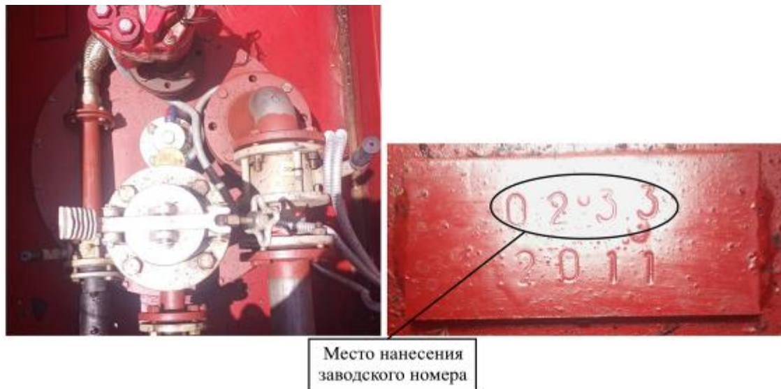
Рисунок 8 – Горловина и измерительный люк резервуара РГП 25-1-2(0,85)-О-У зав.№ 0233
