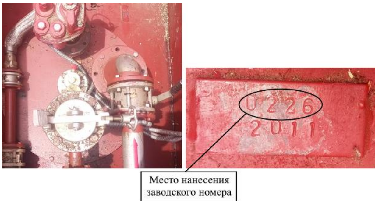
Рисунок 5 – Горловина и измерительный люк резервуара РГП 25-1-2(0,85)-О-У зав.№ 0226
