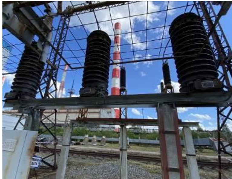
Рисунок 1 – Общий вид трансформаторов напряжения
