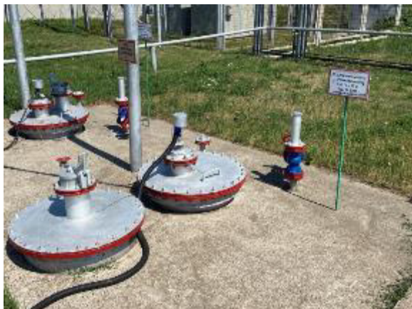
Рисунок 2 – Горловины и замерный люк резервуара
