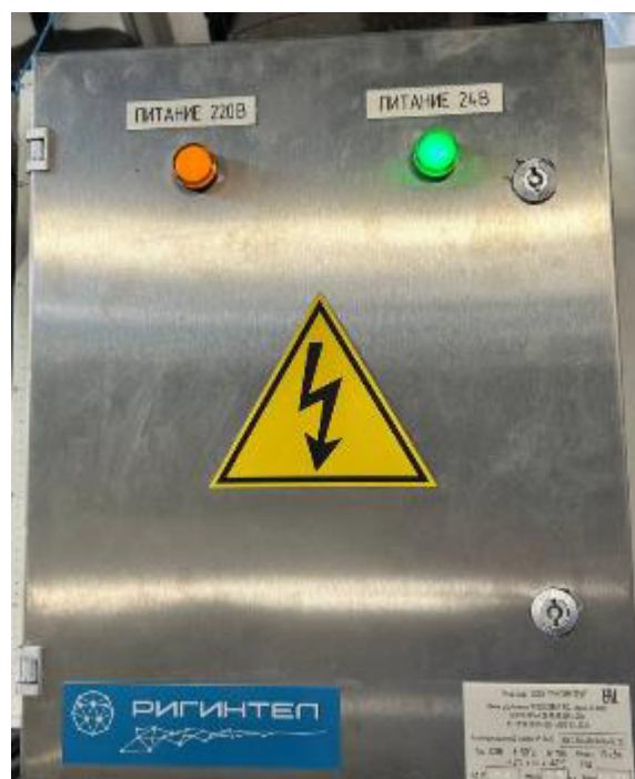
Шкаф управления программно-логическим контроллером (ШУПЛК)
