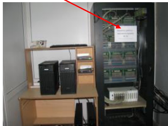
Рисунок 2 – Шкаф системы сбора данных (ССД)
