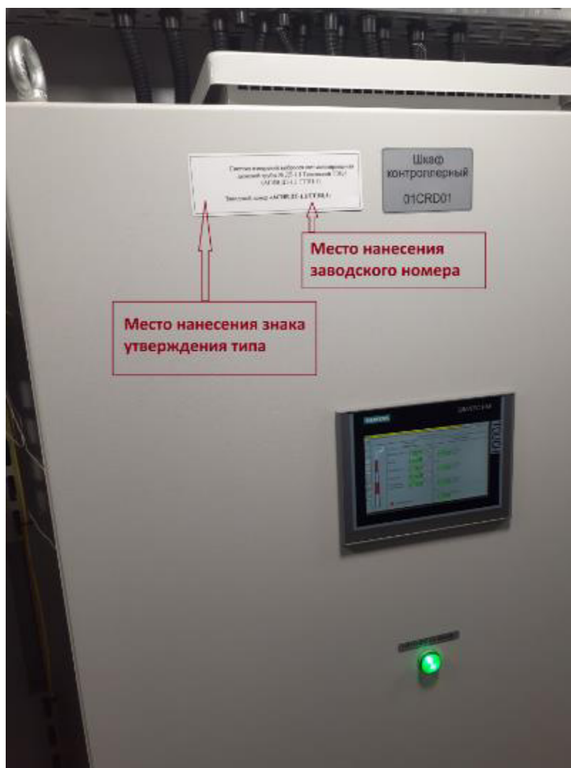
Рисунок 1 – Шкаф контроллерный. Место нанесения знака утверждения типа и заводского номера
