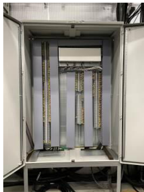
Рисунок 4 – Шкаф кроссового оборудования
