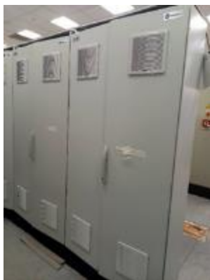
Рисунок 1 – Общий вид контроллерных Шкафов
