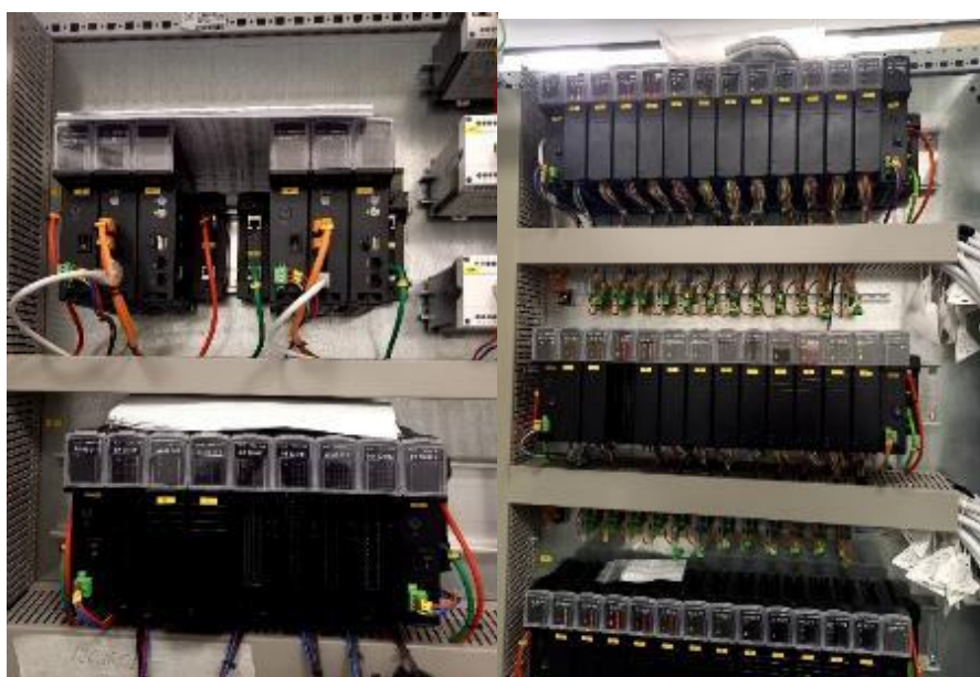
Рисунок 3 – Оборудование в контроллерных шкафах
