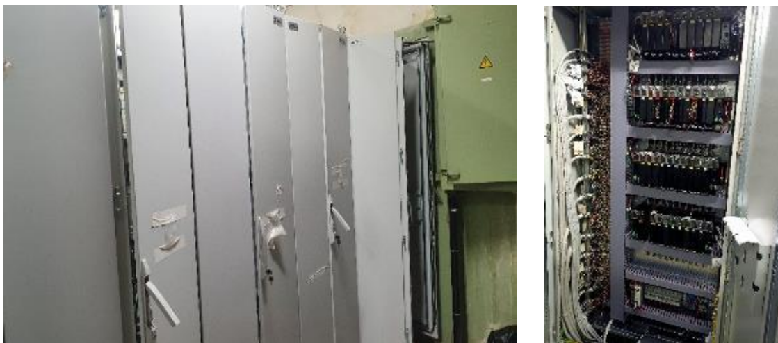
Рисунок 1 – Общий вид шкафов автоматизации и размещение контроллерного оборудования в шкафу
