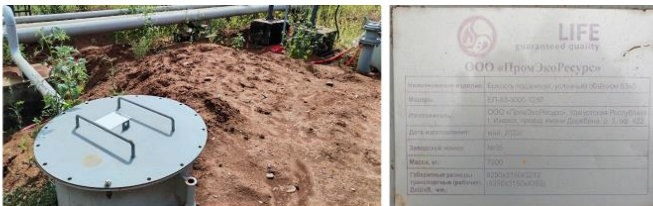
Рисунок 4 – Общий вид маркировочной таблички и горловины резервуара ЕП-63-3000-1250 зав.№ 35
