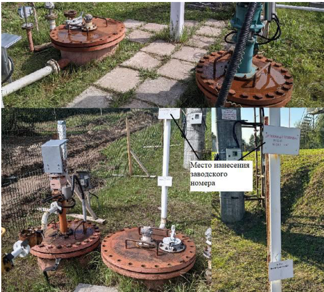
Рисунок 1 – общий вид резервуаров горизонтальных стальных цилиндрических РГС, модификаций РГС-16 зав. № ЕП-1 и РГС-8 зав. № ЕП-2 с указанием места нанесения заводского номера
