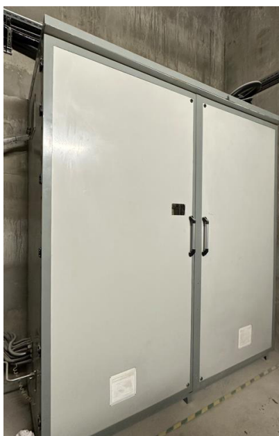
Рисунок 1 – Общий вид аналитического шкафа, в котором размещен газоаналитический комплекс MCS100FT и ИВК
