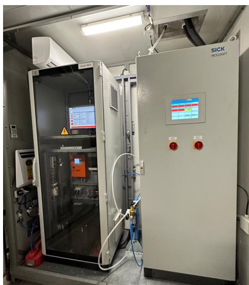
Рисунок 2 – Общий вид аналитического шкафа с открытой дверью
