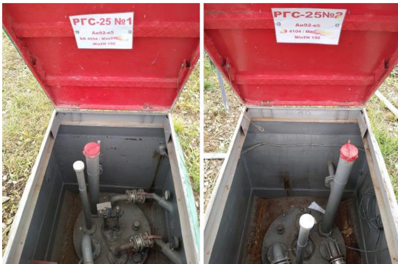
Рисунок 2 – Горловины резервуаров РГС-25 зав.№№ 1, 2
