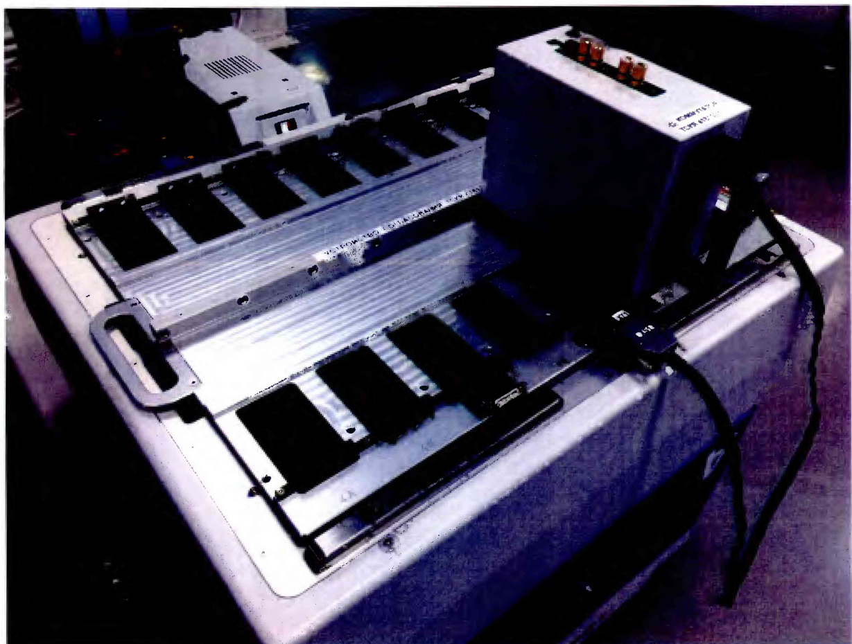
Рисунок 20 – Устройство согласования ТСКЯ.418133.370-00 и коммутатор ТСКЯ.418137.002 установленный в позиции 1В
